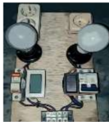
Gambar 2. Perbandingan MCB DC Dan MCB AC Beban AC Dan Beban DC
